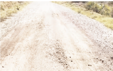
రోడ్డు నిర్మాణాన్ని పూర్తి చేసి, కిన్నెరవాడ-తొగిల గ్రామ ప్రజలకు ఈ ఇబ్బందుల నుంచి విముక్తి కల్పించాలని స్థానికులు, వాహనదారులు కోరుతున్నారు.
